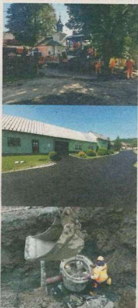
Asfaltování u kapličky sv. Františka z Assisi po stavbě nové splaškové kanalizace v Tupci
